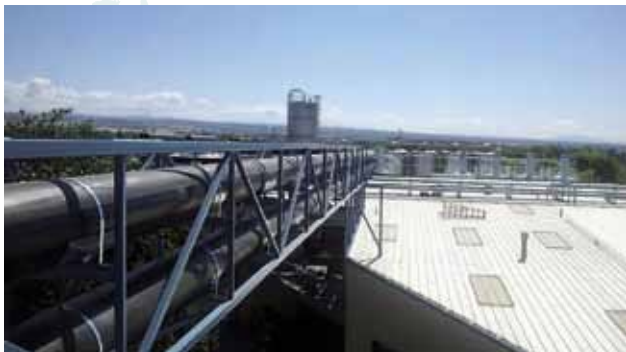
Ausseninstallation von Cool Fit ABS Plus für das Kühlsystem aller Gärkeller der Sierra Nevada Brewing Company
